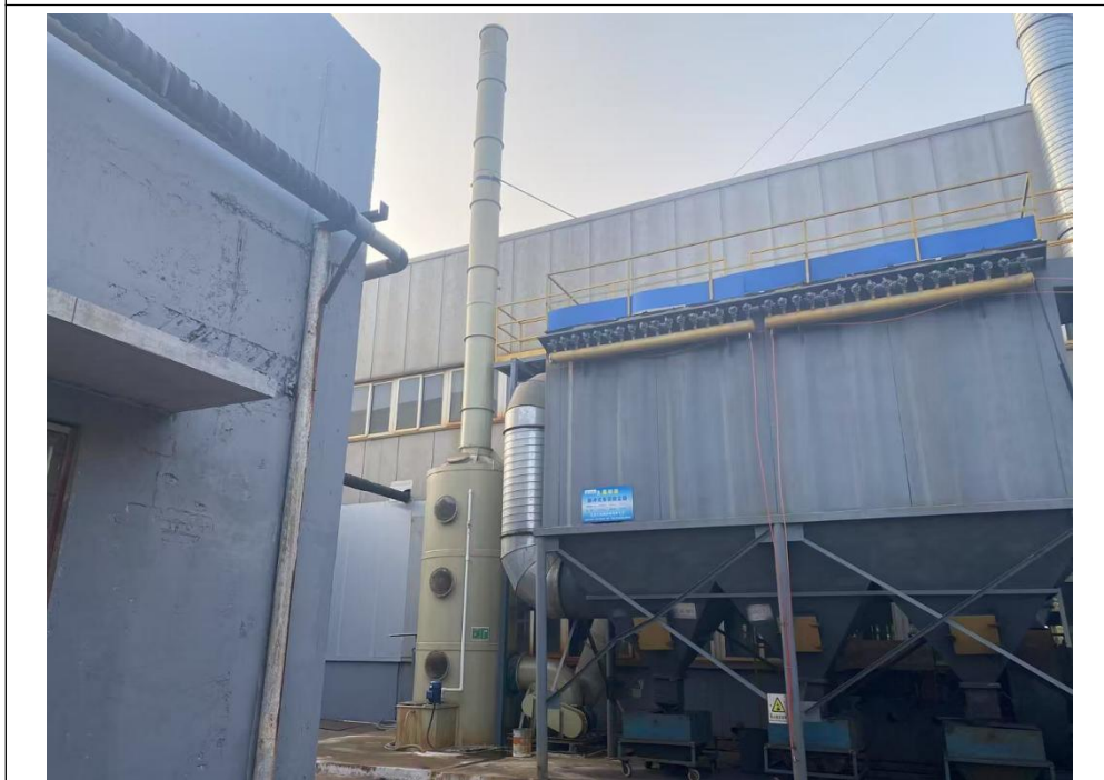
6号厂房酸雾喷淋塔排气筒 P4*
