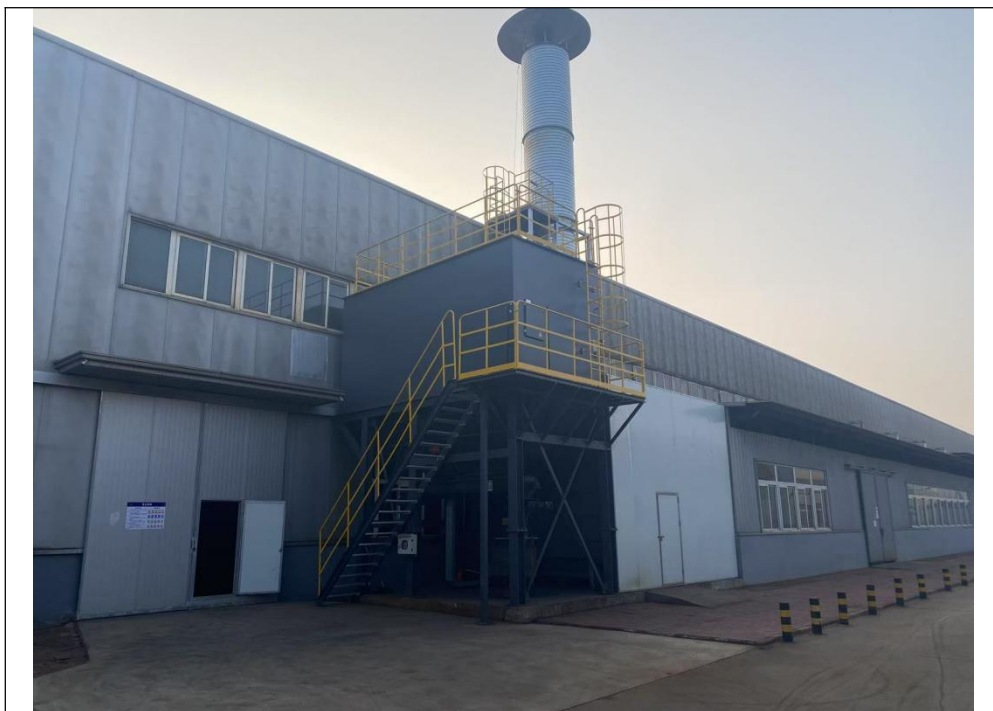
5号厂房布袋除尘排气筒 P9*
