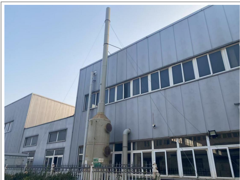
6号厂房酸雾喷淋塔排气筒 P5*
