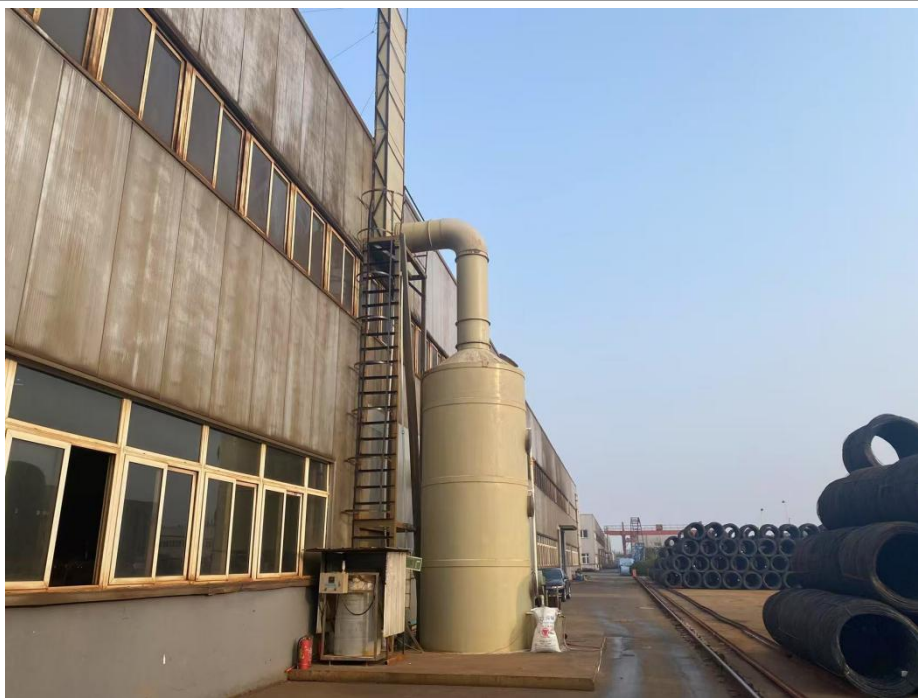
5 号厂房酸雾喷淋塔排气筒 P2*
