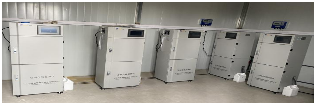
污水总排口（pH 值、总铜、总氮、总磷、BOD 5 、COD Cr ）在线监测
