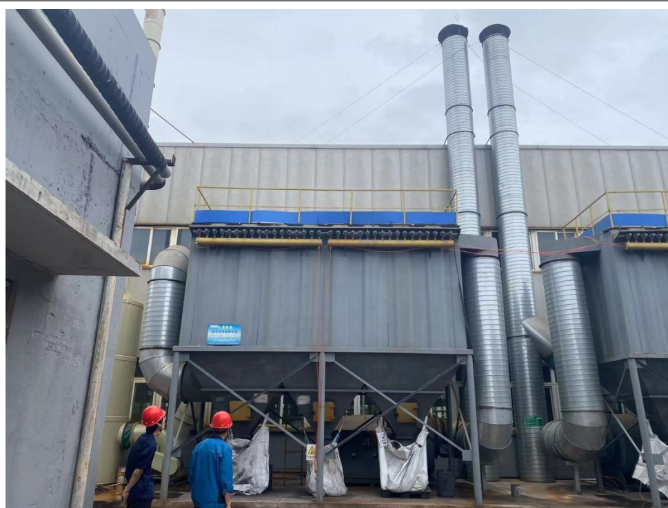
6号厂房布袋除尘排气筒 P11*、P12*
